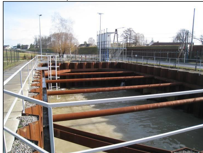
Fot. 4 Przepompownia na wschód od analizowanego obszaru
